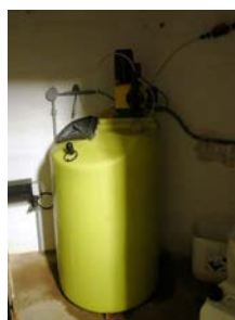
La pompe à chlore
